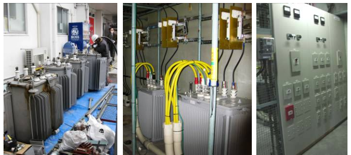
左から 取り外した旧設備、新設備変圧器、新設備配電盤
